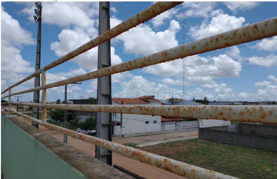
Foto 17 – alambrado com corrosão verificada em outro módulo de arquibancada.
