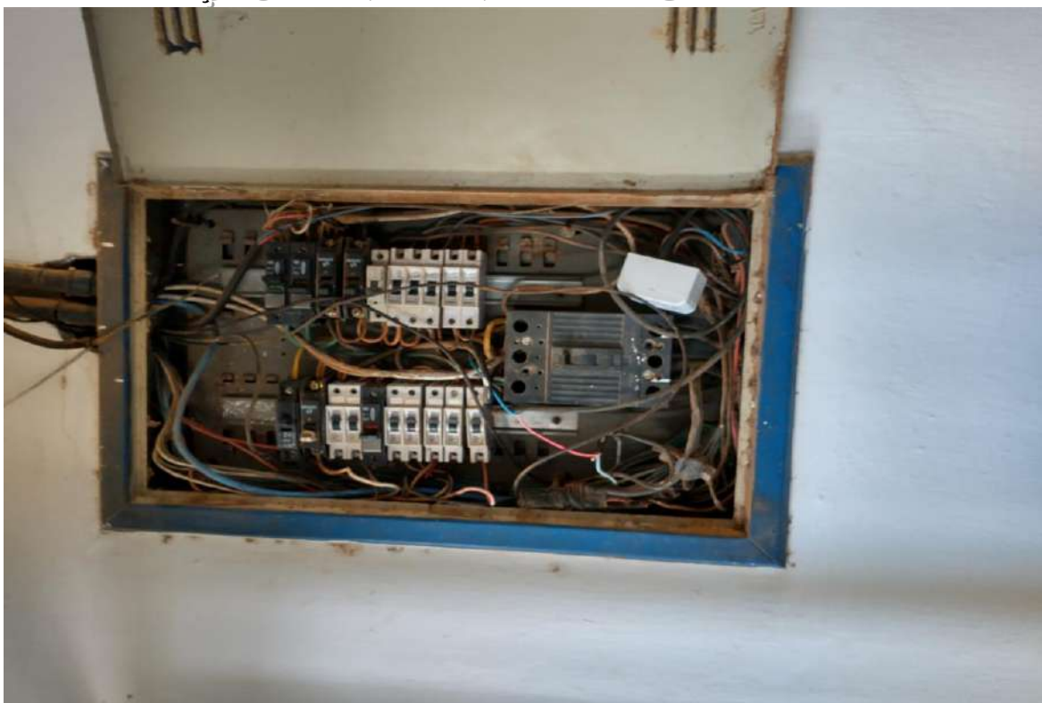
Foto 05 – Quadro de disjuntores
