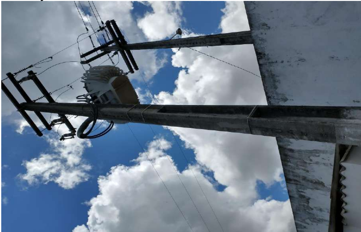
Foto 11 – Transformador de entrada
