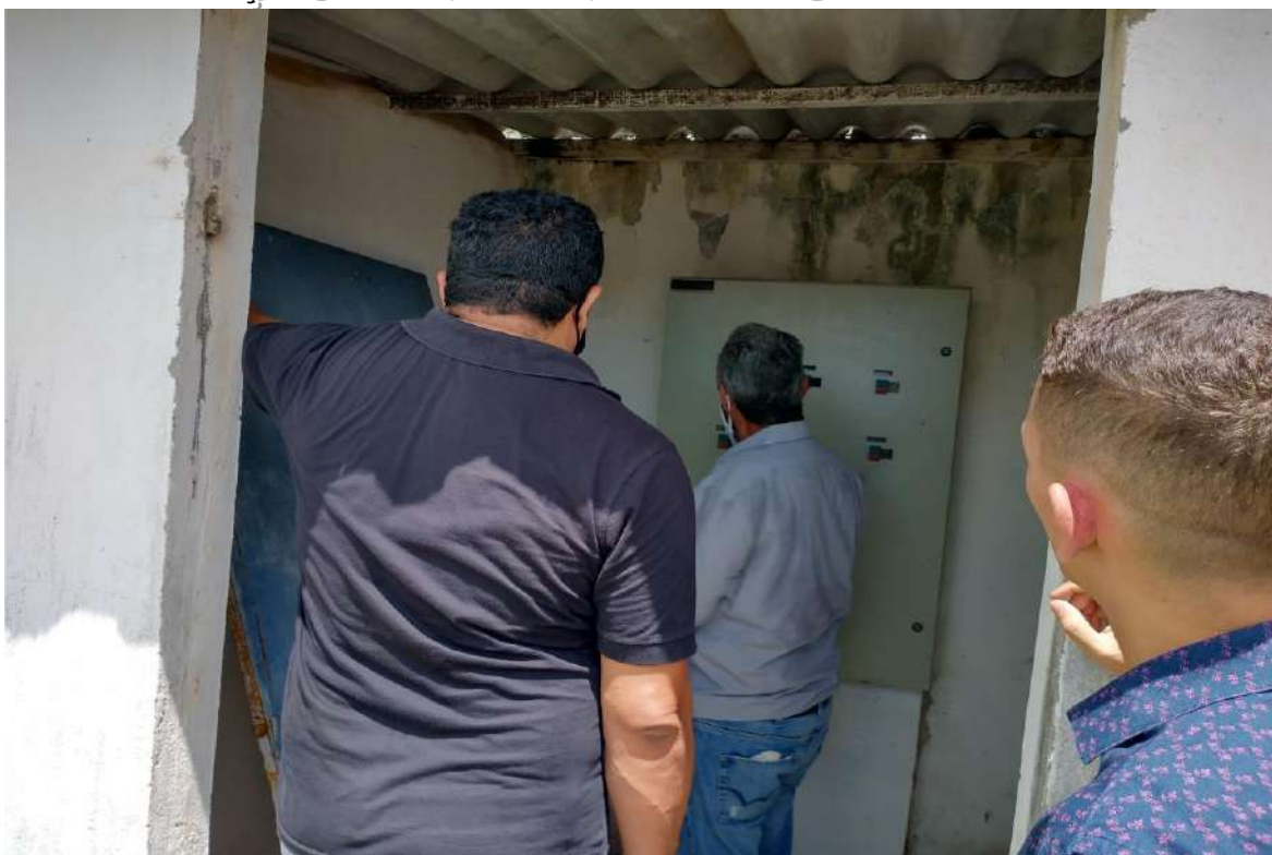
Foto 07 – Quadro de iluminação
