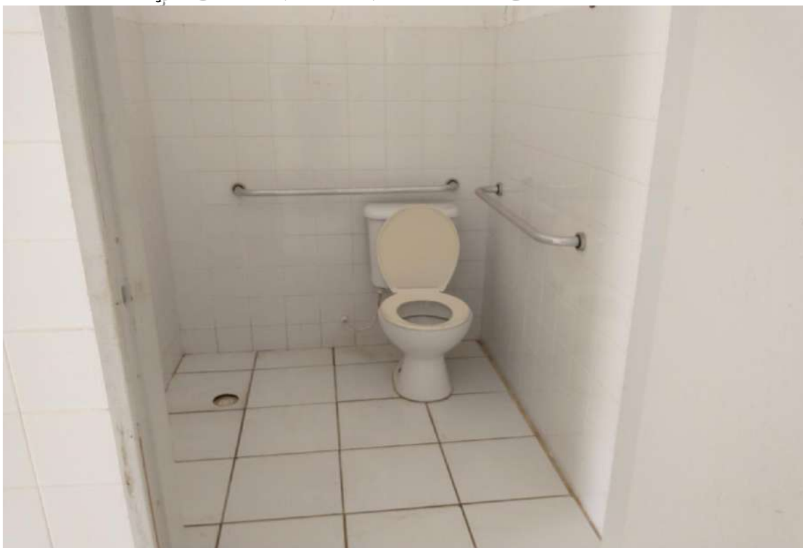
Foto 15 - Sanitário destinado aos portadores de necessidades especiais
