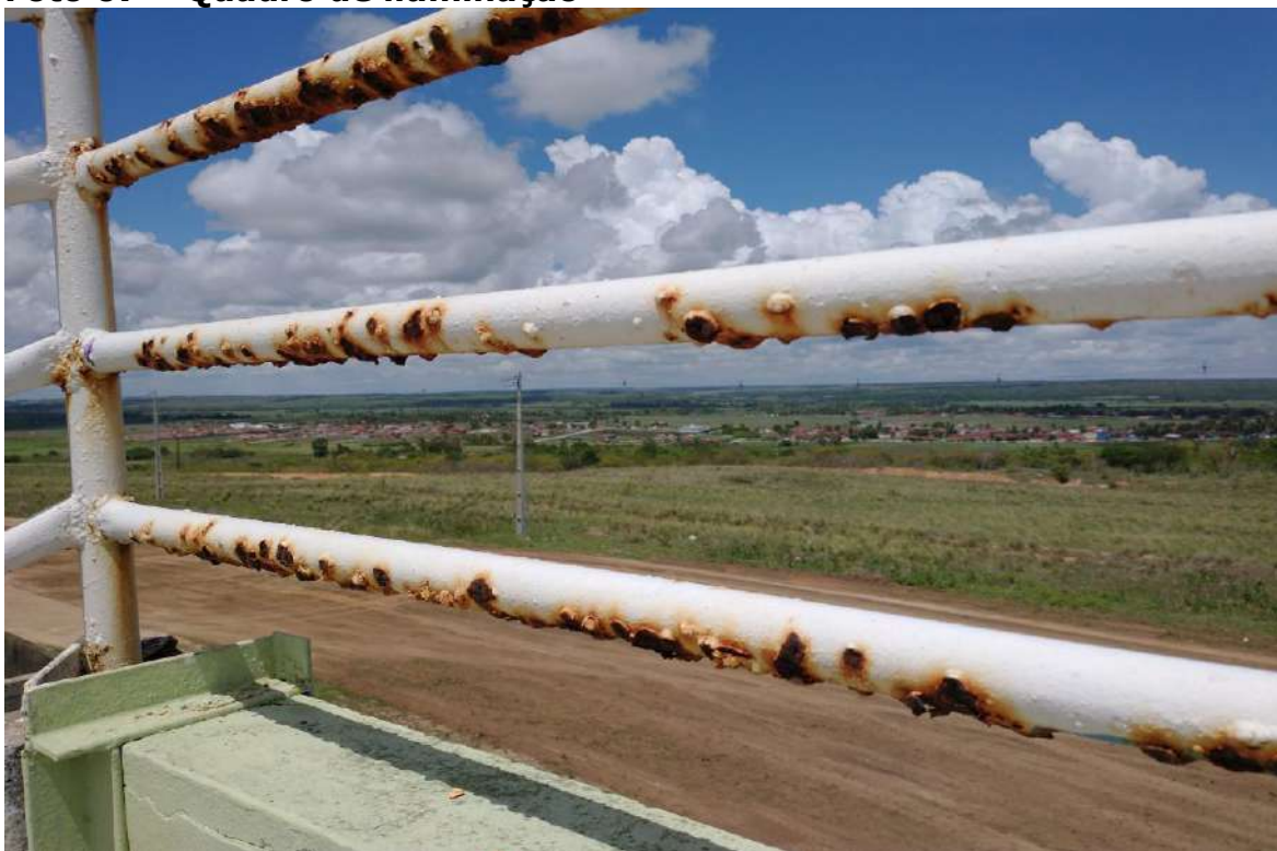
Foto 08 – Alto índice de corrosão nos alambrados
